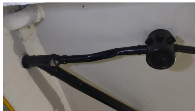
Figura 1. Tubulação do ramal de esgoto deformada.
