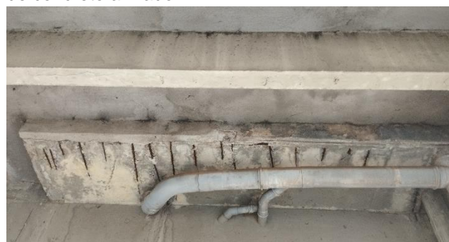
Figura 2. Calha em concreto armado para drenagem pluvial com infiltração.
