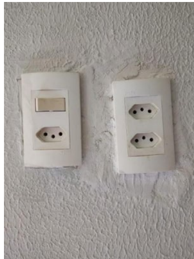
Figura 4 - Tomada de três pinos em uma residência Fonte: Acervo próprio.
