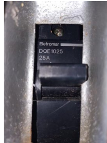
Figura 6 - Interruptor do medidor de energia Fonte: Acervo próprio.
