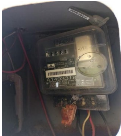
Figura 5 - Medidor de energia em residência de Teresina Fonte: Acervo próprio.
